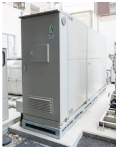
ヒートポンプ本体
