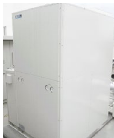
ヒートポンプ
