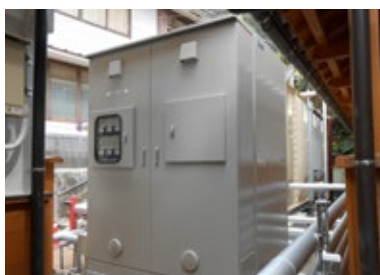
ヒートポンプ本体（試運転時）
