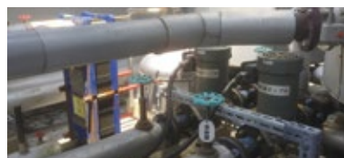
熱源ポンプとプレート式熱交換器
