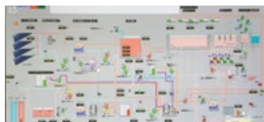
運転監視モニター (一部)
