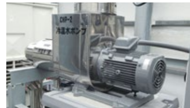
冷温水ポンプ
