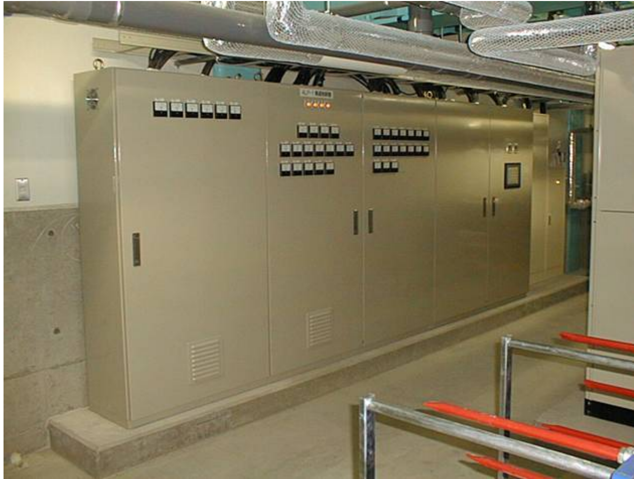
写真 付知峡温泉おんぼいの湯 制御盤
