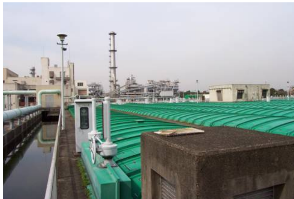
下水処理場(最終沈殿池)
