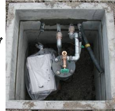
ピット内 二重管
