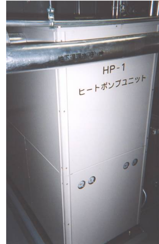
地中熱源水冷式ヒートポンプ
