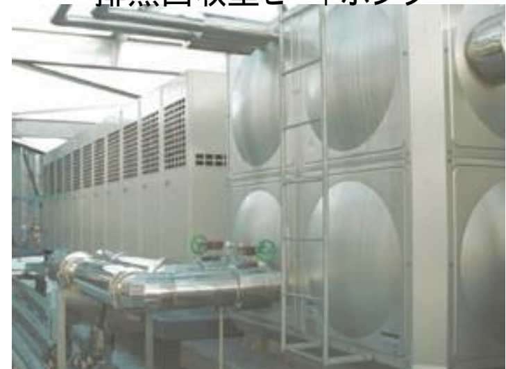
排熱回収型ヒートポンプ + 貯湯槽
