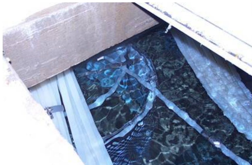
排湯熱交換器(架橋ポリエチレンパイプ)
