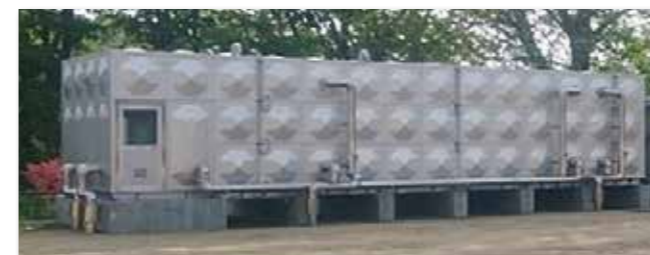
水蓄熱槽(ディフューザー、ポンプ、バルブ、小屋付き)
