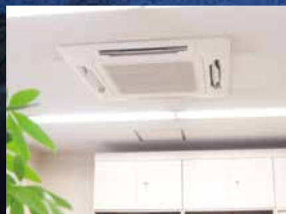
天井に設置された室内機
