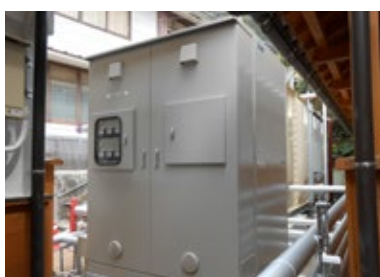
ヒートポンプ本体（試運転時）
