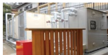
ヒートポンプ本体と貯湯槽（試運転時）
