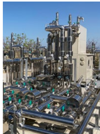
水冷式ヒートポンプチラー外観
