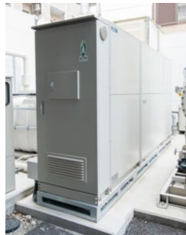
ヒートポンプ本体
