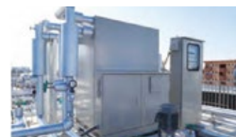
水冷式ヒートポンプチラー
