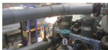
熱源ポンプとプレート式熱交換器
