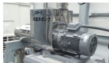
冷温水ポンプ
