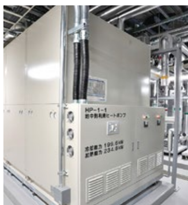
水冷式ヒートポンプチラー
