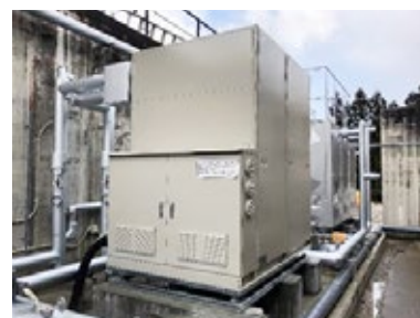
手前：ヒートポンプ 奥：熱源水槽
