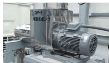
冷温水ポンプ
