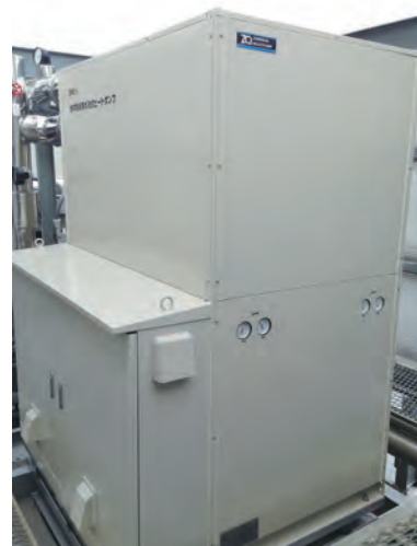
水冷式ヒートポンプチラー
