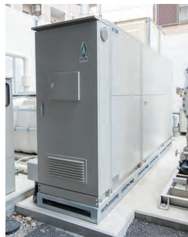
ヒートポンプ本体
