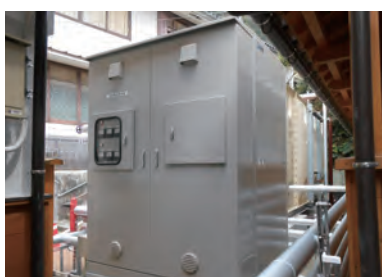
ヒートポンプ本体（試運転時）
