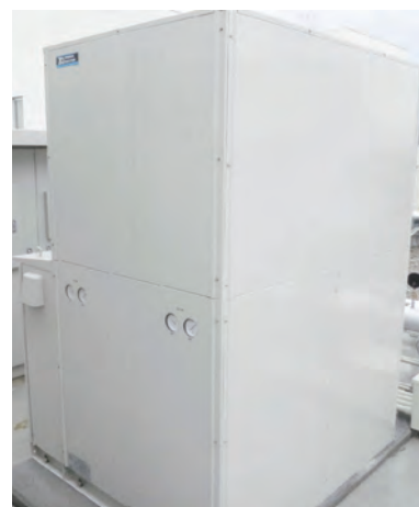
ヒートポンプ
