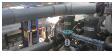
熱源ポンプとプレート式熱交換器
