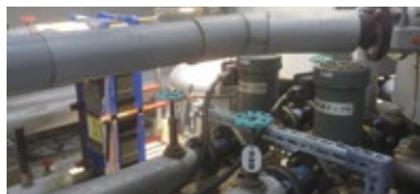
熱源ポンプとプレート式熱交換器
