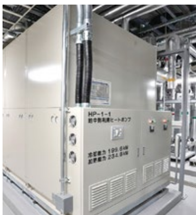
水冷式ヒートポンプチラー
