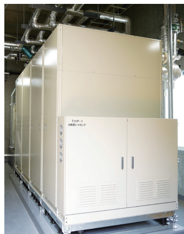
ヒートポンプ本体
