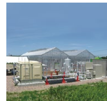
西川浄化センター ルネッサンスシステム 実証プラント 様 (新潟県新潟市) 下 水 熱 下水熱利用ヒートポンプ(温室への冷水供給・暖房・冷房)
